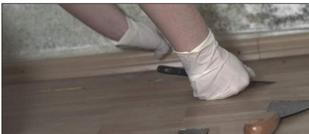
Mit der miniaturisierten Sonde kommt man gut an die engen Stellen, an denen sich Schimmel bildet.
