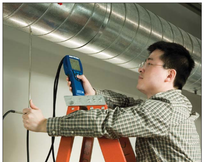
Strömungsmessung mit Prandtl-Staurohren
